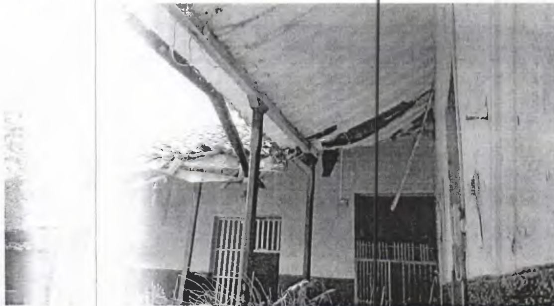
Cubierta: estructura en mal estado. bahareque, vigas y correas de madera en mal estado, canales arruinados
