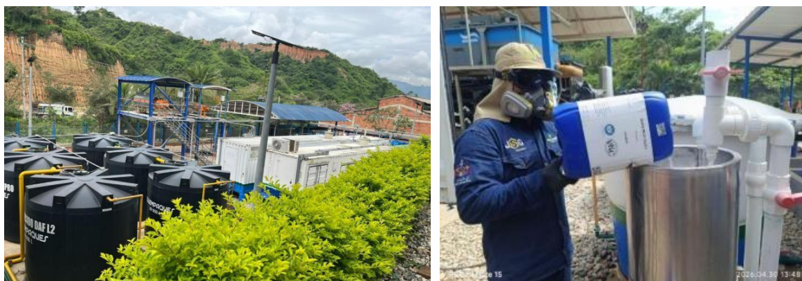
Gráfico 65. Planta de Tratamiento de Lixiviados PTLX
