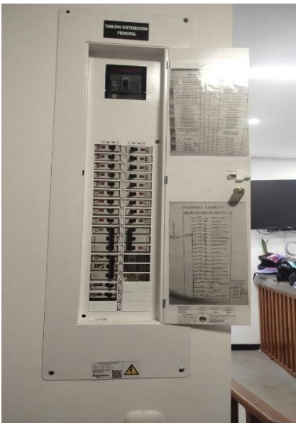
IMAGEN No 4. TABLERO GENERAL DESPUES
