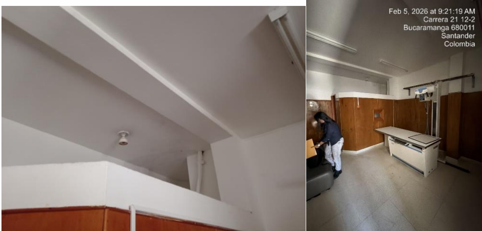
Fotografías 4 y 5. Humedad en la placa dentro de zona de Rayos X.
