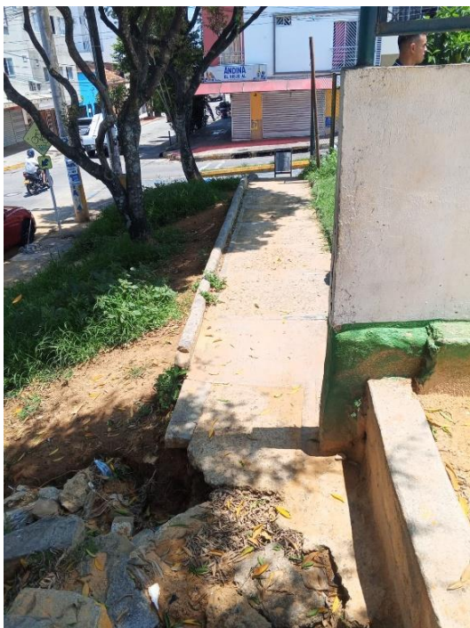
Sardinel destrozado, concreto en mal estado
