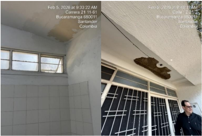
Fotografías 8 y 9. Placa afectada por humedad en zona de Pediatría
