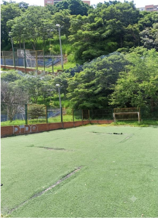
Cancha sintética deteriorada
