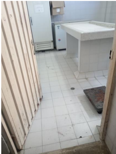
Fotografía 13. Sifón de la morgue, junto al acceso al sótano
