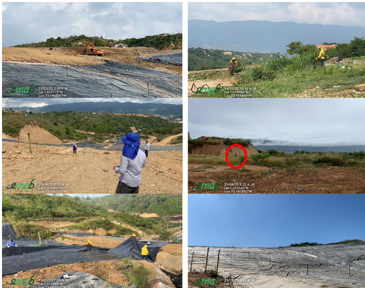
Ilustración 12 Actividades de cierre y clausura celda de contingencia y celda de respaldo 1, primer semestre de 2025
