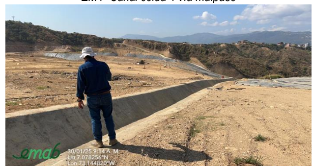
EM7- Canal 1 – Celda de Contingencia
