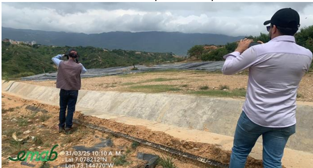
EM7- Canal 1 – Celda de Contingencia
