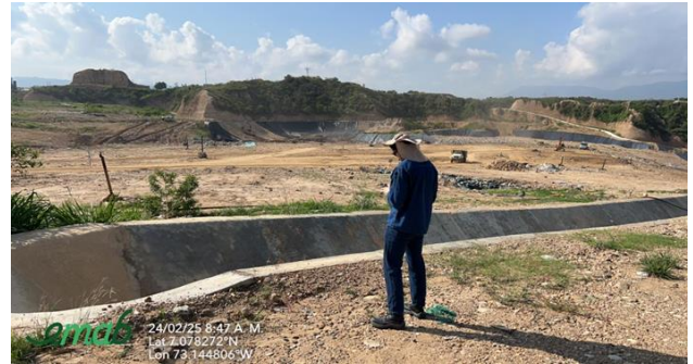
EM7- Canal 1 – Celda de Contingencia
