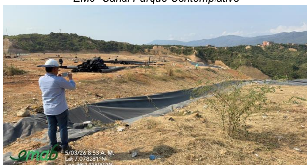
EM7- Canal 1 – Celda de Contingencia
