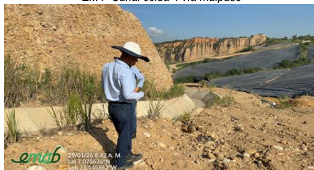
EM7- Canal 1 – Celda de Contingencia
