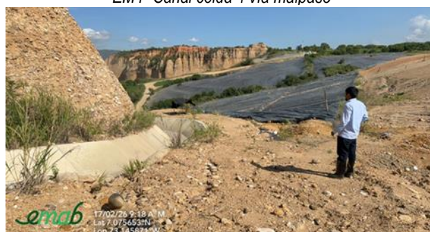
EM7- Canal 1 – Celda de Contingencia
