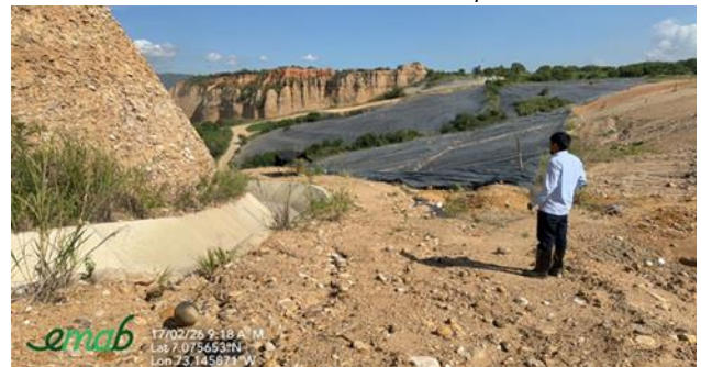
EM7- Canal 1 – Celda de Contingencia
