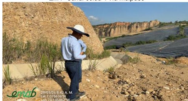
EM7- Canal 1 – Celda de Contingencia
