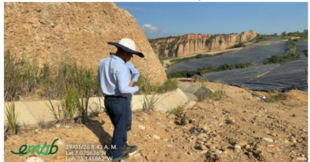
EM7- Canal 1 – Celda de Contingencia
