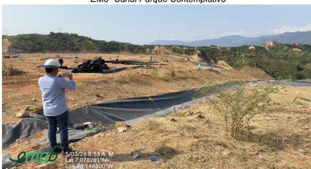
EM7- Canal 1 – Celda de Contingencia
