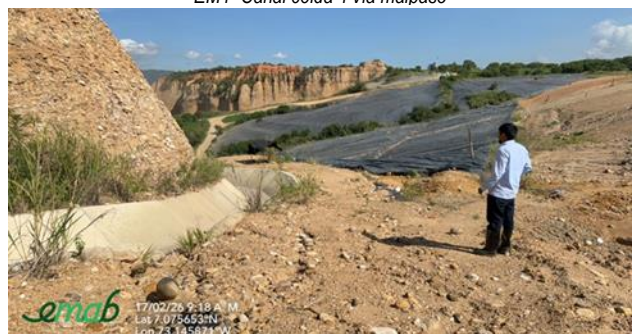
EM7- Canal 1 – Celda de Contingencia
