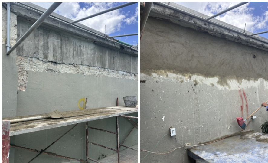
REGISTRO FOTOGRÁFICO REALCE Y FRISO EXTERIOR DE VIGAS LONGITUDINALES TANQUE #1 MORRO ALTO.
