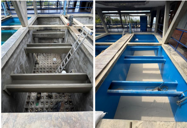
FILTRO No 4 PTAP LA FLORA
