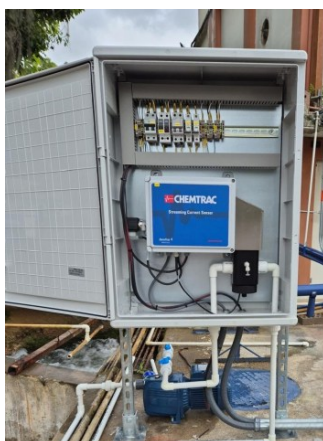
FIGURA 26 INSTALACIÓN STREAMING CURRENT PTAP MORRO RICO
