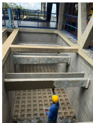
FIGURA 22 APLICACIÓN CAPA DE MORTERO Y REVESTIMIENTO Sika TOP 121 DEL FILTRO NO 4 PTAP LA FLORA
