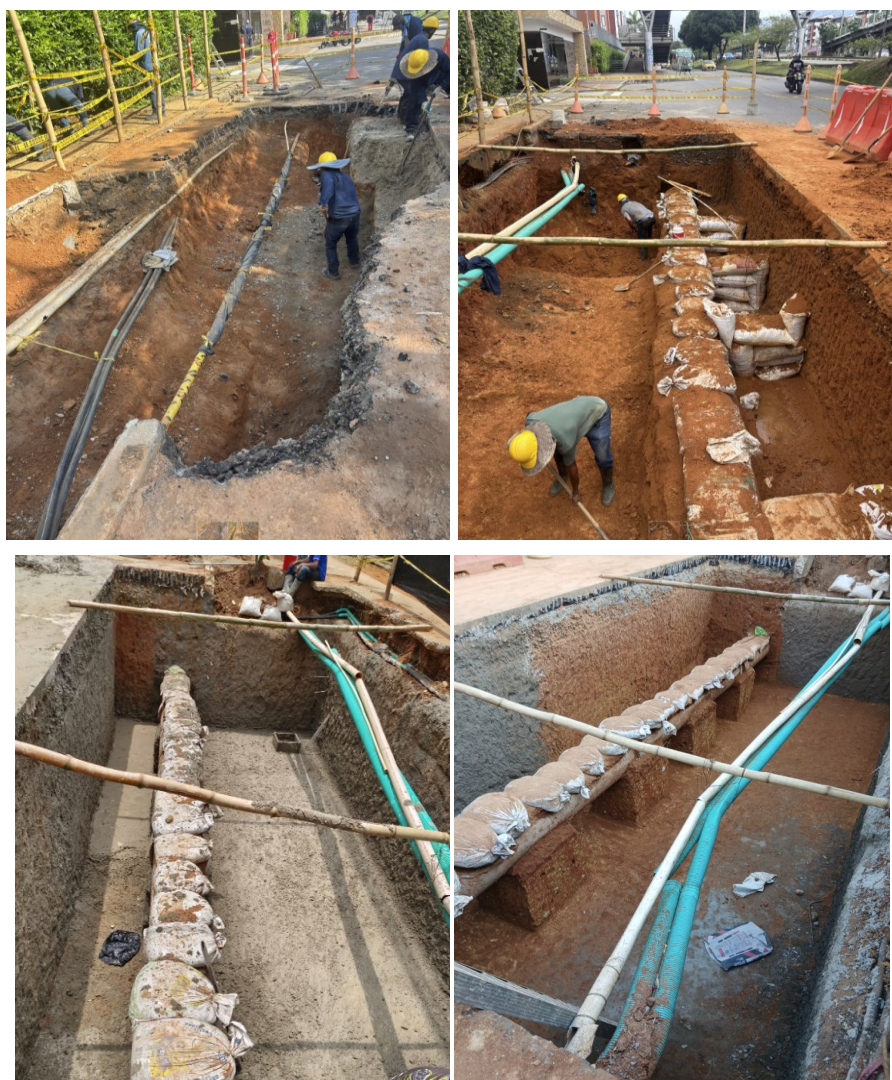
FIGURA 36 REGISTRO FOTOGRÁFICO DE CONSTRUCCIÓN DE CÁMARA PARA LA INSTALACIÓN DE EQUIPOS ESPECIALIZADOS EN EL CONTROL Y MONITOREO DE PARÁMETROS HIDRÁULICOS EN LAS REDES DE DISTRIBUCIÓN
