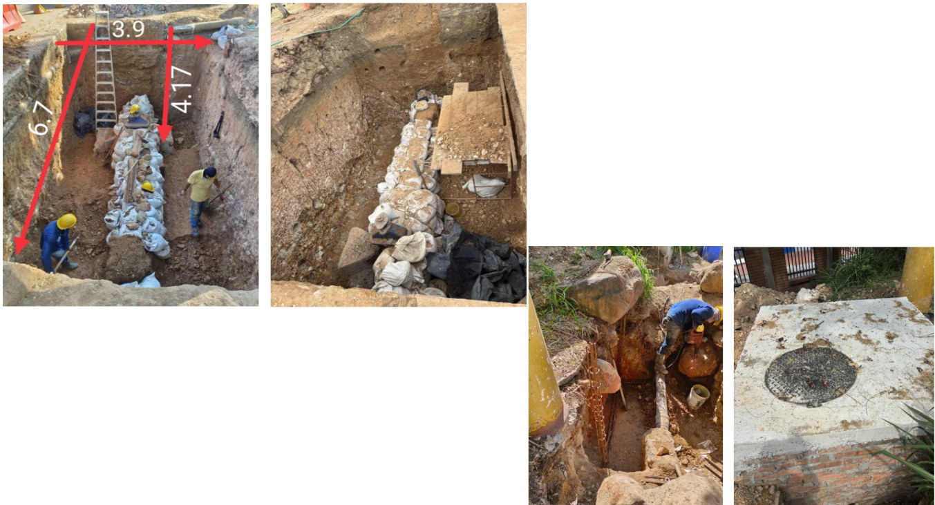
REGISTRO FOTOGRÁFICO DE CONSTRUCCIÓN DE CÁMARAS PARA LA INSTALACIÓN DE EQUIPOS ESPECIALIZADOS EN EL CONTROL Y MONITOREO DE PARÁMETROS HIDRÁULICOS EN LAS REDES DE DISTRIBUCIÓN
