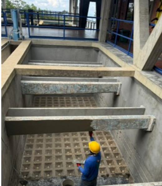
Aplicación Capa de Mortero y revestimiento Sika Top 121 del Filtro No 4 PTAP La Flora
