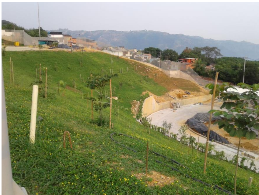
ESTADO DEL TALUD CENTRAL UBICADO ENTRE LA ZONA DE PATIO TALLER Y ESTACION DE TRANSFERENCIA
