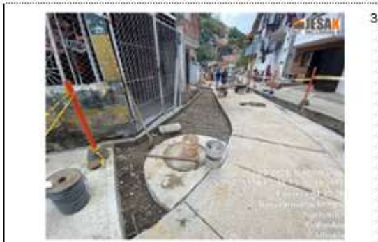
Localización: cr 51 # 19b-33 entre cr 51# 19b-47 Descripción: instalación de bas e y acero de refuerzo dovelas
