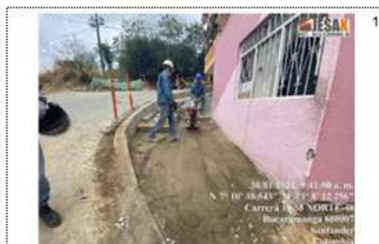
Localización: tramo # 3 Costado Oriente Cll 58N des de la Cra 20 hasta volver a encontrar la intersección con la Cra 20 Descripción: instalación de sub-base
