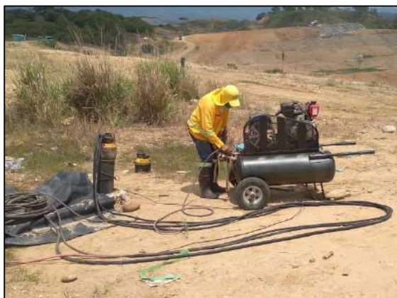
Ilustración 19 Extracción forzada de lixiviados pozo 1 celda 1.
