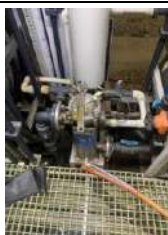
Tubería de entrada de la DTRO
