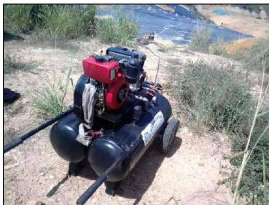
Ilustración 20 Extracción forzada de lixiviados pozo 1 celda 4.
