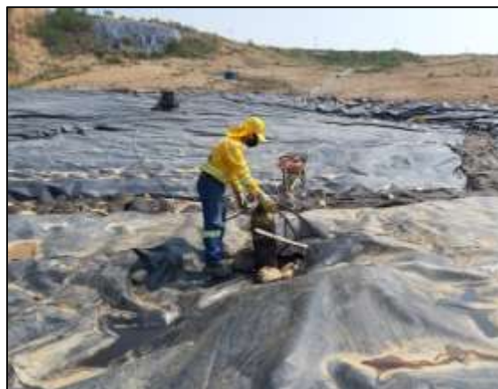
Ilustración 30 Extracción forzada de lixiviados pozo 1 celda 4.
