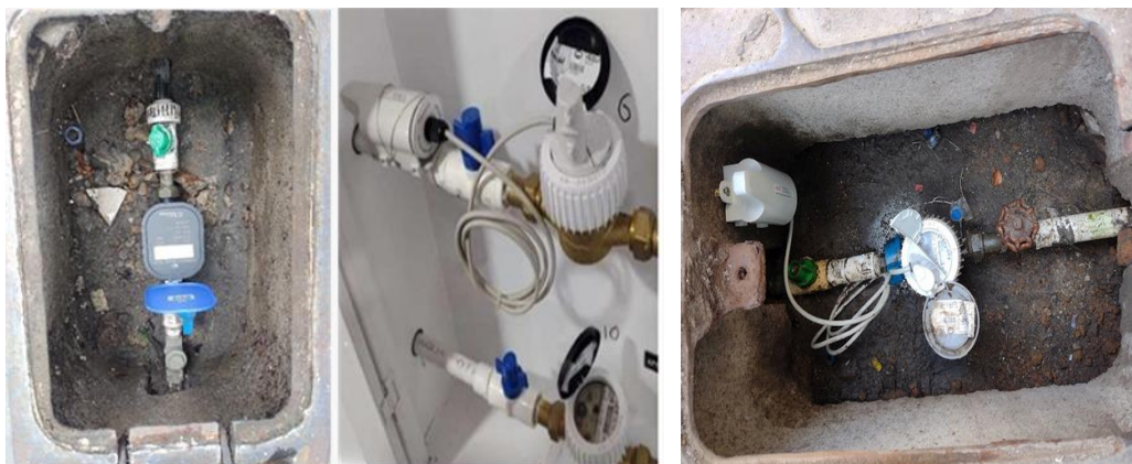
FIGURA 14. IMAGEN DE MEDIDOR ULTRASÓNICO Y MECÁNICO EN APTO Y CAJILLA PISO CON EQUIPOS DE TRANSMISIÓN
